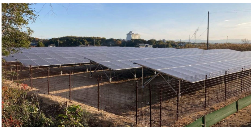
オフサイトに設置した太陽光発電設
