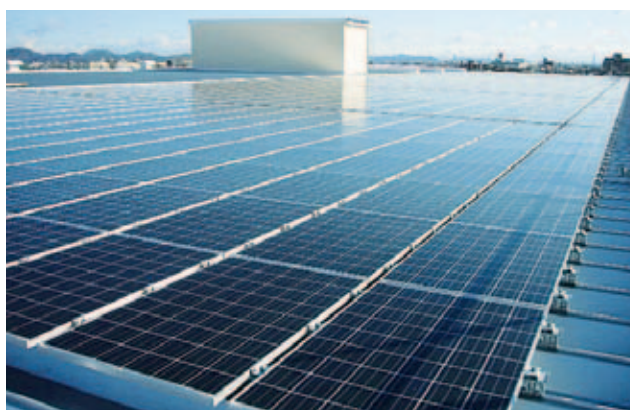
〈岐阜工場の太陽光発電設備〉 平成20年度太陽光発電新技術等フィールドテスト事業（財団法人新エネルギー財団）
