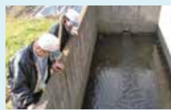
雨水調整池の油浮き確認
